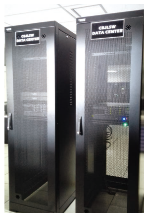
联合实验室数据中心
